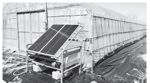
ソーラーパネルを活用したハウス自動開閉システム
